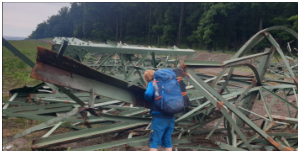
Na snímku vidíme téměř nový sloup s nepatrným poškozením, mřížka je skoro celá, pouze má pár bodových deformací, což ovšem jeho stabilitu nemůže ohrozit...
